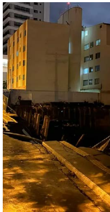
Asfalto em frente à construção de um edifício desmorona
